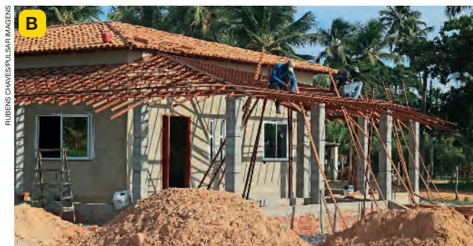
Trabalhadores construindo uma casa no município de Estância, no estado de Sergipe, em 2024.
