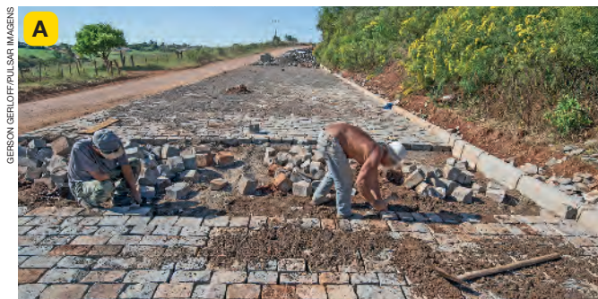
Trabalhadores colocando paralelepípedos em estrada no município de Estrela Velha, no estado do Rio Grande do Sul, em 2023.
